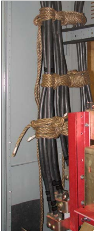
Figure 25 – Exemple de l'entrave de câble
