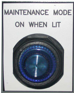
Figura 8 – Luz indicadora de modo de mantenimiento local
